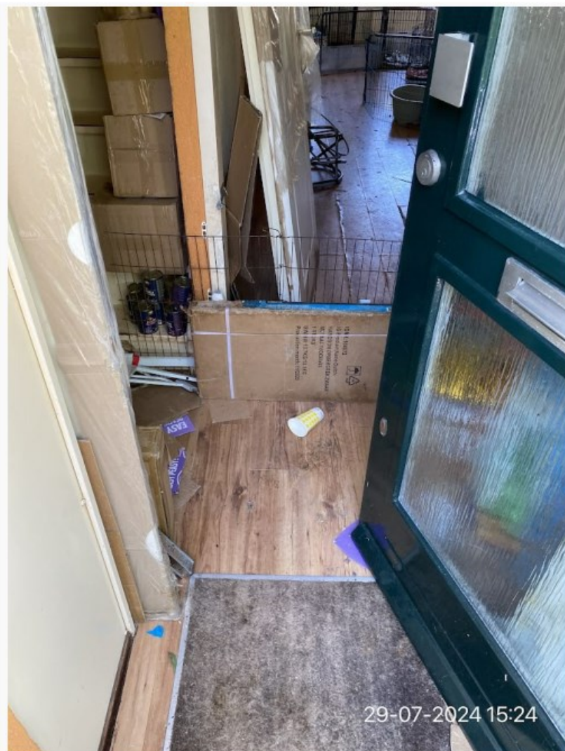
Foto 76; Voordeur, deur hal woonkamer niet aanwezig.
