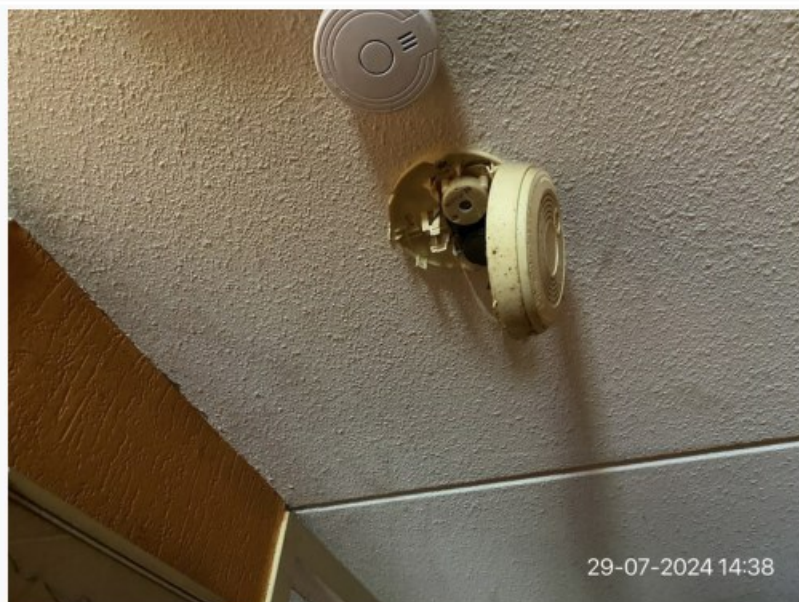
Foto 70; Rookmelder verdieping is defect, zeer brandgevaarlijk.
